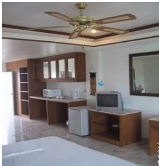
ventilatore a pale da soffitto
