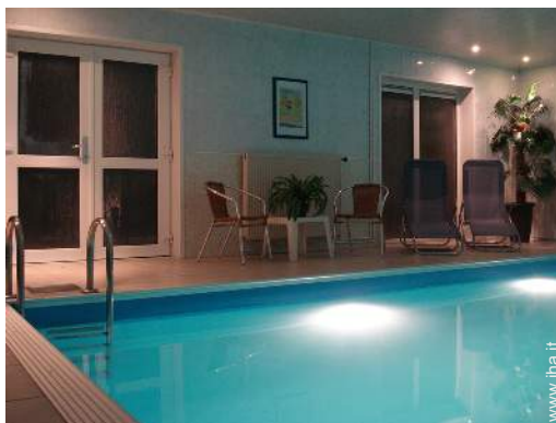
sistema di illuminazione
